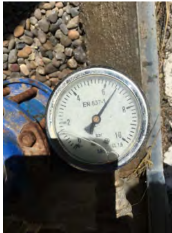
Mesurament amb manòmetre dia 28/04/2020
