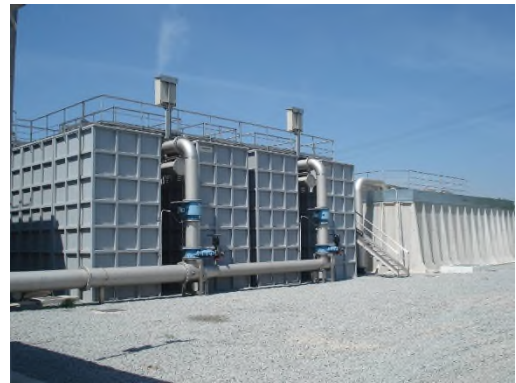
Imatge 8: Filtres i Dipòsit aigua tractada
